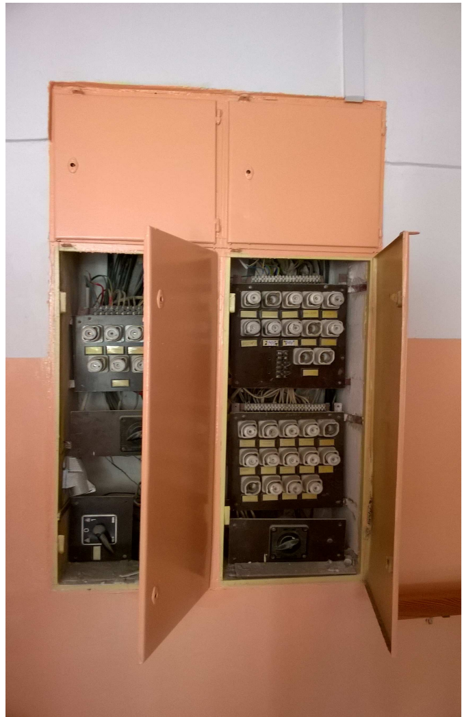
Widok istniejącej rozdzielnicy TP2
